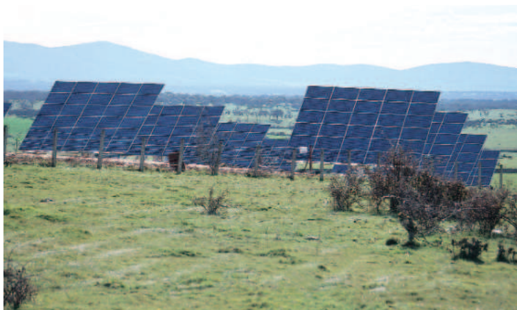
Central solar fotovoltaica ligada à rede. Íñigo de Huebra (Salamanca).
