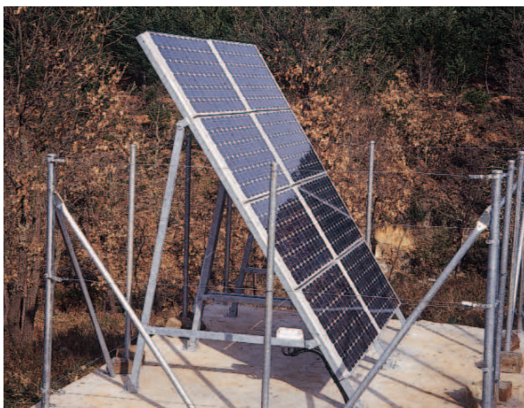
Exemplo de instalação simples fotovoltaica.
