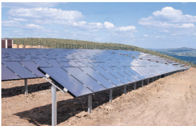
Central solar fotovoltaica conectada a la red, Freixo de Espada-à-Cinta.
