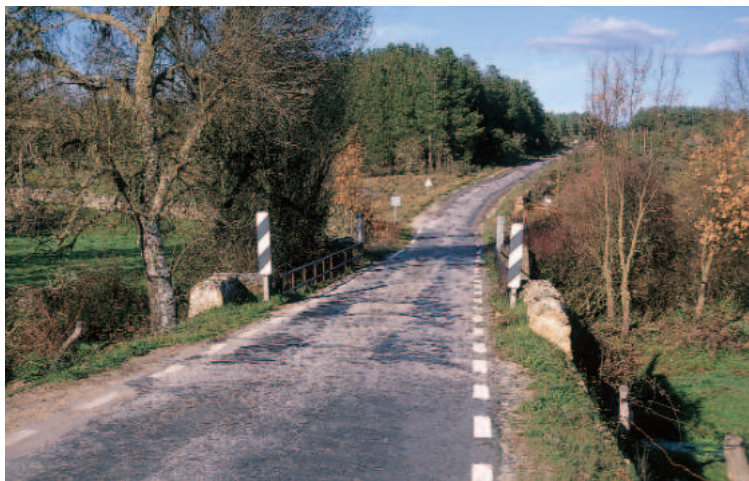
Estado actual deficitario de la carretera Casilla de Flores-Navasfrías.
