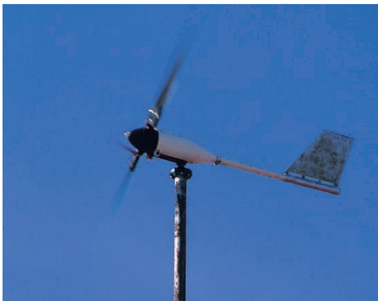
Instalación de energía eólica en una nave de Linares de Riofrio (Salamanca).
